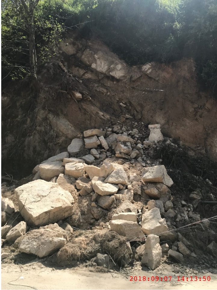
Figure A-19: Rock fall @ 10.0835676° N 77.0615970° E
